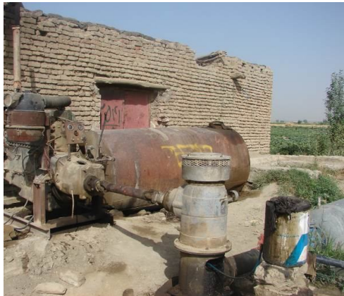
شکل 1- نامناسب بودن زیر ساخت و مستعمل بودن موتور پمپ‌های دیزلی مورد استفاده در ایستگاه‌های پمپاژ
